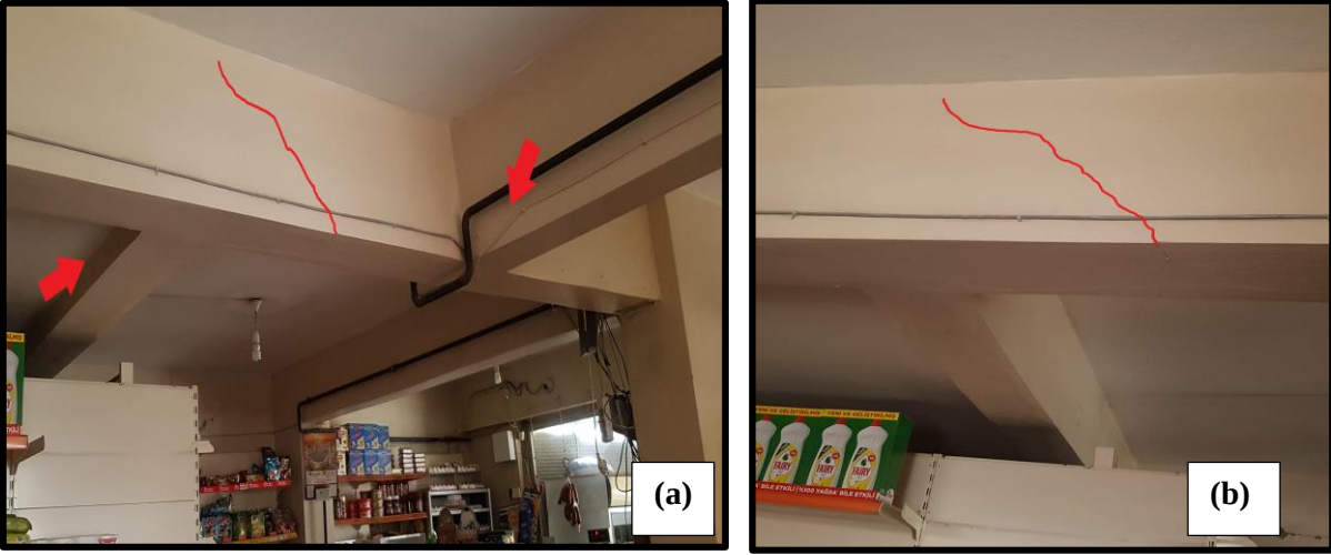
Şekil 4.63 Zemin katta tali kirişlerin mesnetlendiği ana kirişlerde meydana gelen kesme çatlakları
