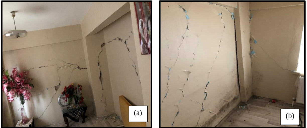
Şekil 4.52 Dolgu duvar hasarları
