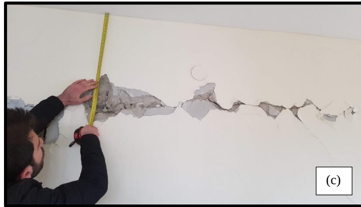
Şekil 4.136 Dolgu duvar hasarları
