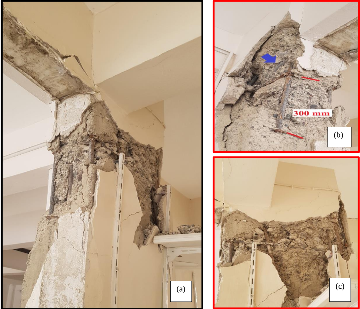
Şekil 4.120 Ağır hasar gören kolon ve malzeme detayları
