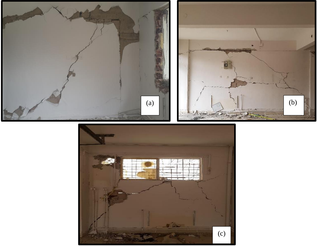
Şekil 4.121 Dolgu duvar hasarı
