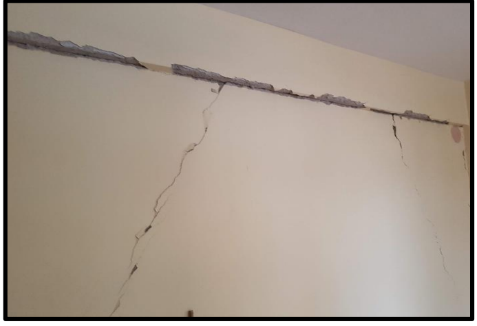
Şekil 4.93 Dolgu duvar hasarı
