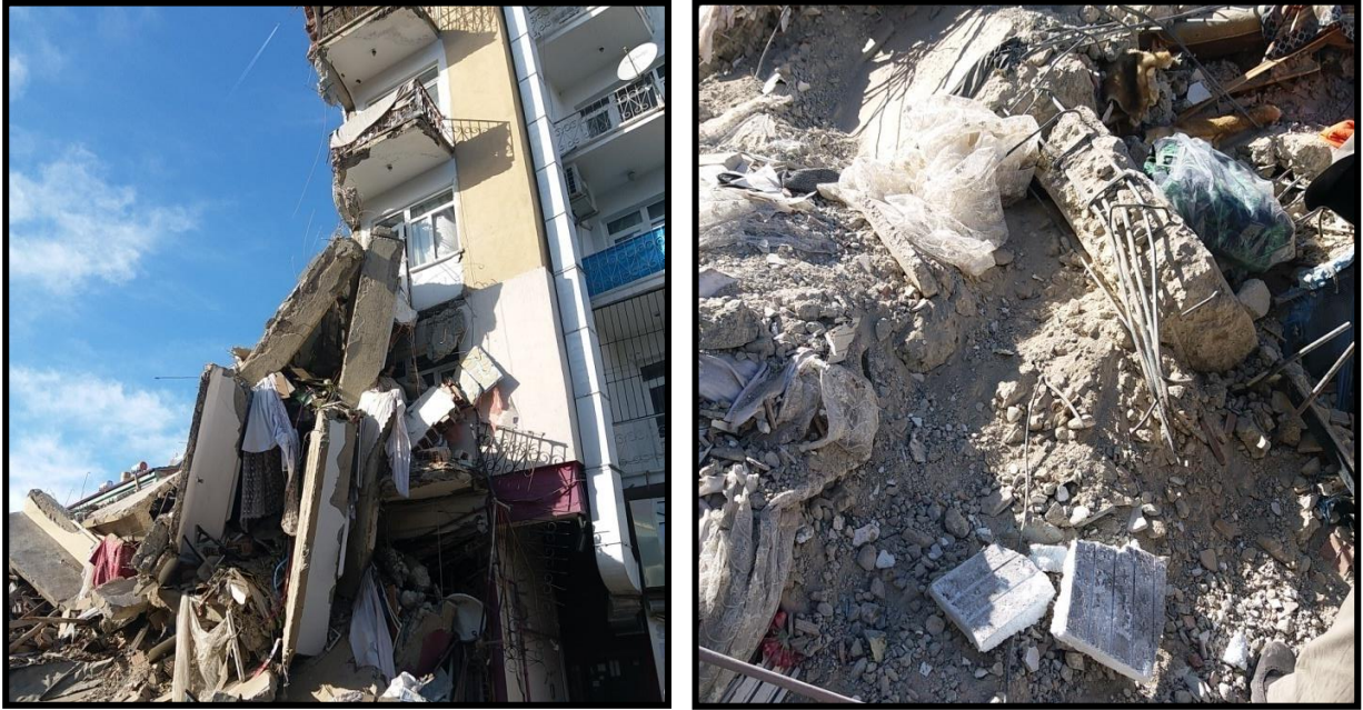
Şekil 4.57 Tamamen dayanımını kaybeden bina
