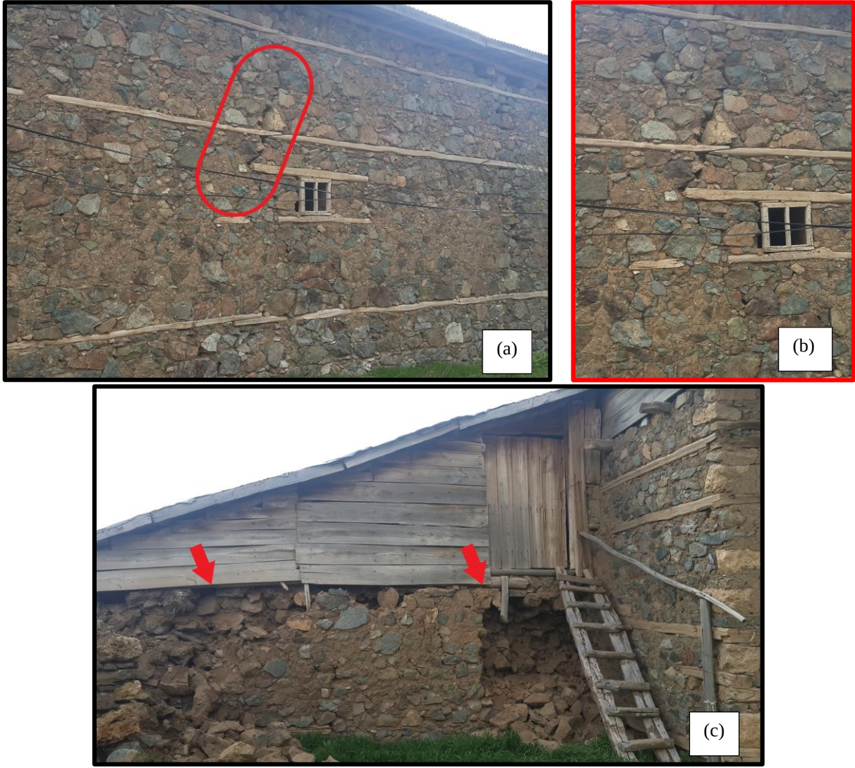
Şekil 5.7 4 Nisan 2019 Kavakköy-Sivrice Depremi'nde hasar gören yığma bina
