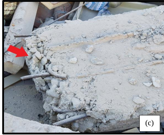
Şekil 4.101 Göçen binanın kolonlarındaki donatı düzeni ve kullanılan beton malzemesi
