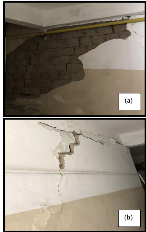
Şekil 4.76 Dolgu duvar hasarları
