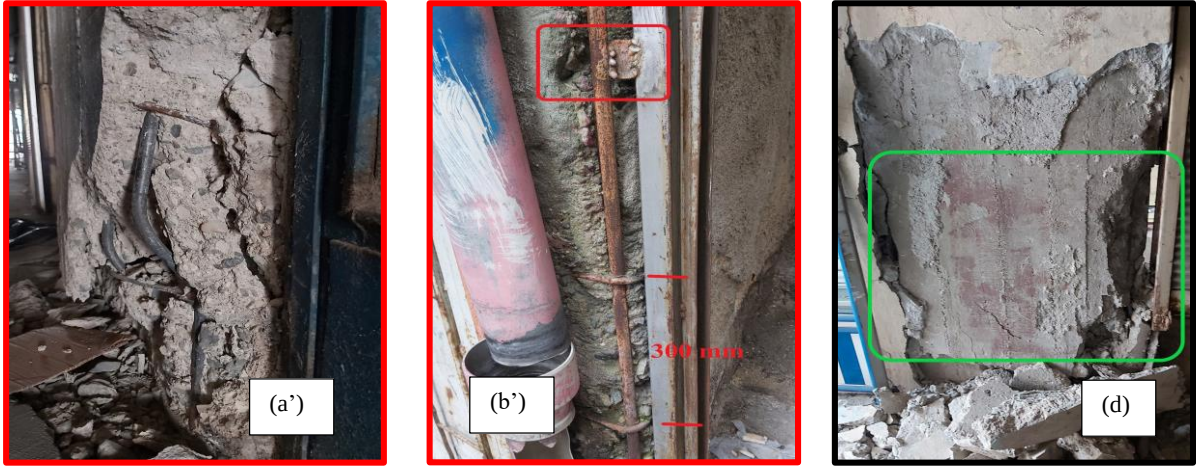
Şekil 4.74 Zemin kat kolon hasarları ve donatı düzenleme detayları
