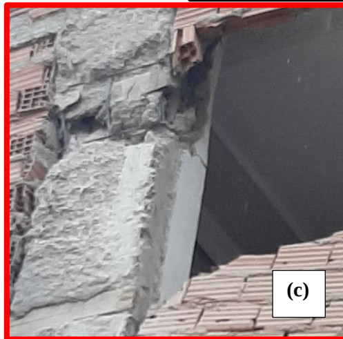
Şekil 4.69 Bina ve taşıyıcı sistem görüntüsü a-b) dış cephe görüntüleri, c) yıkılan binanın çekiçleme etkisi sonucu hasar gören birinci kat köşe kolonu
