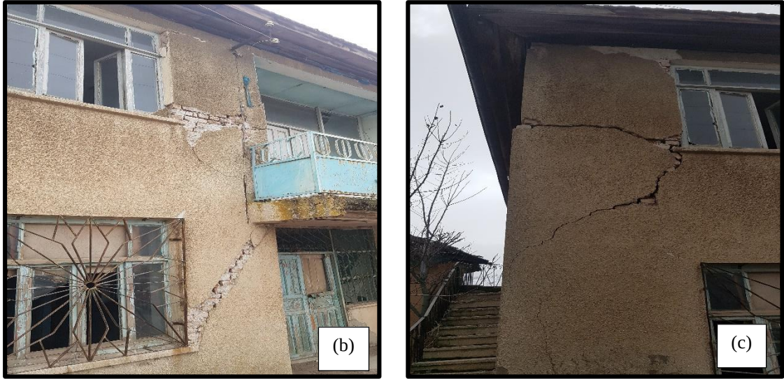
Şekil 5.5 Sivrice ilçe merkezinde hasar gören yığma bina
