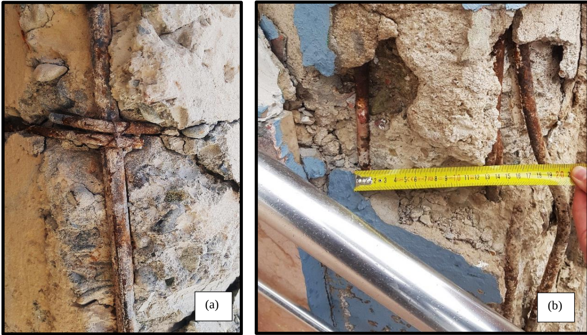
Şekil 4.18 Korozyon gözlenen kolon donatıları
