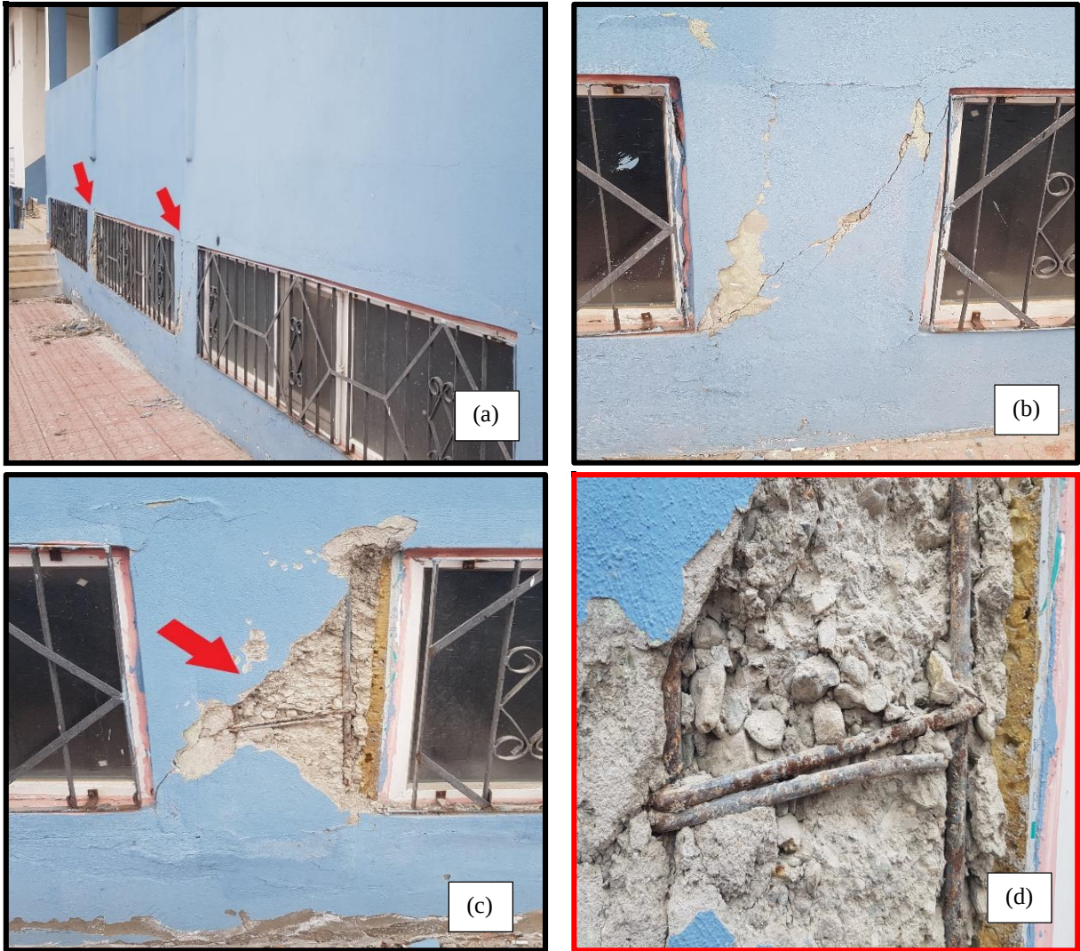
Şekil 4.131 Kısa kolon düzensizliği nedeniyle hasar gören kolonlar ve donatı detayı
