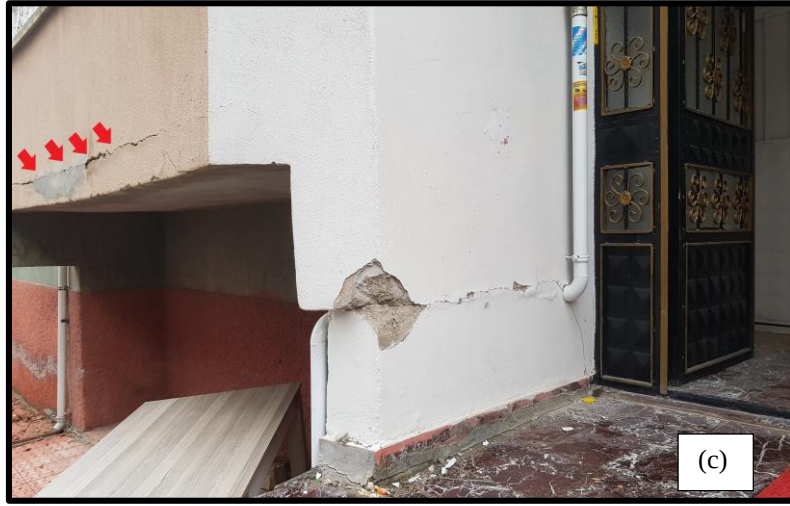
Şekil 4.112 Sitenin cephe görüntüleri ve sehim gözlenen balkon döşemesi
