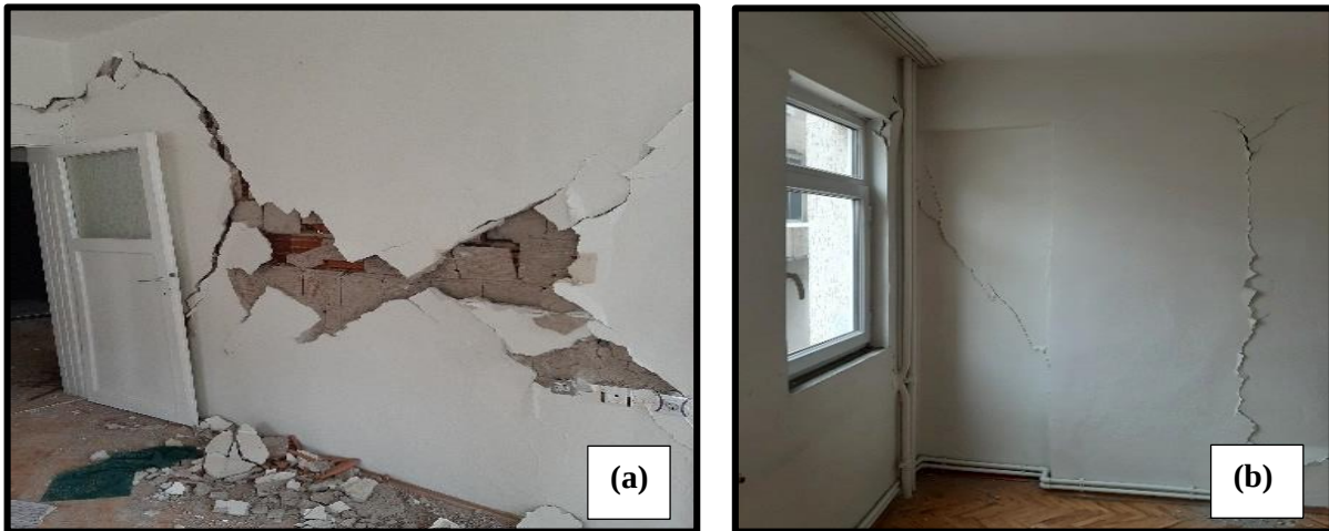
Şekil 4.64 Binada gözlenen dolgu duvar hasarları
