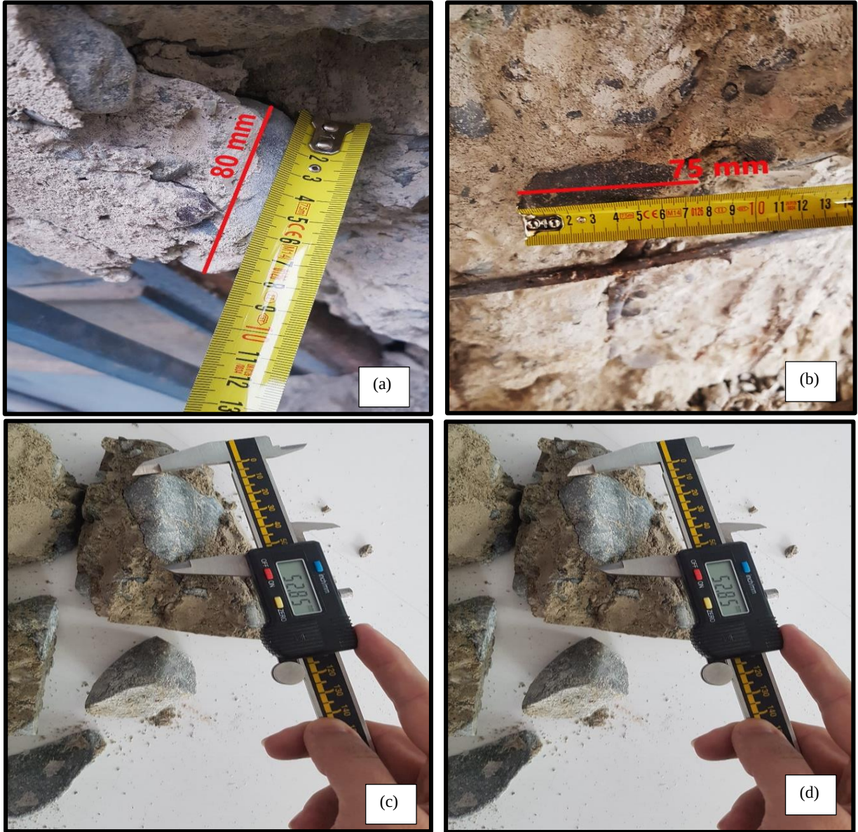
Şekil 4.16 Eski bina stoku olarak tanımlanan binaların betonları; a-b) yerinde gözlemlenen betonlara ait agrega örnekleri, (c) laboratuvarıda basınç dayanımı testi sonucunda dağılan beton numunesinde görülen agrega, (d) laboratuvarıda kesilen numune parçasında görülen büyük agrega parçası.
